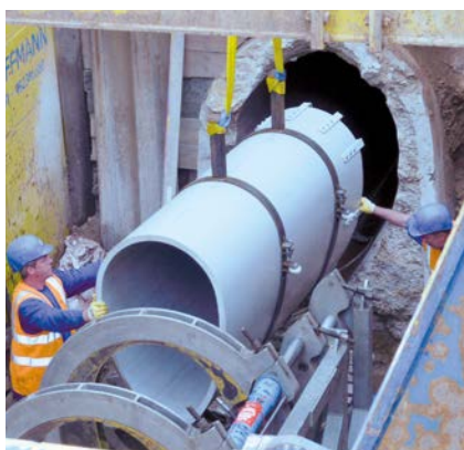
Renowacja kanalizacji ściekowej za pomocą profili owalnych SIMONA® PE 100 w kolorze jasnoszarym
