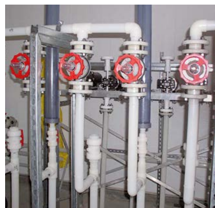
Rury i kształtki SIMONA® PVDF w instalacji do fluorowania wody
