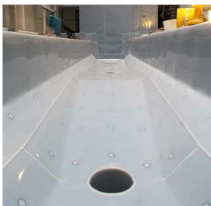
Wykładzina stałego punktu kanału gazu dymnego z płyt SIMONA® PFA
